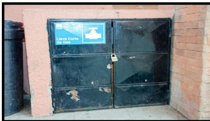
CONEXIÓN DE GAS (CASINO CHICO)
